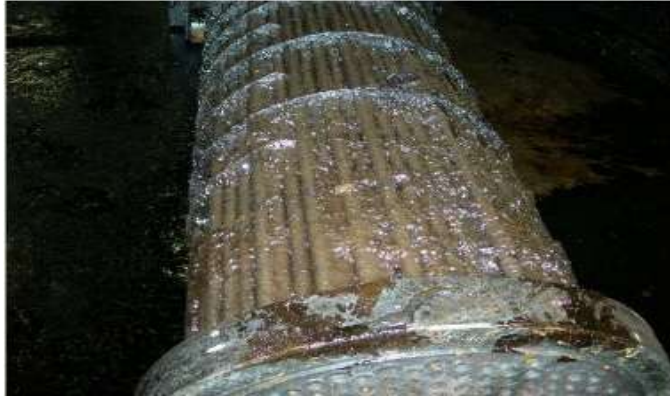
Figure 8- Exemple d'un faisceau de tubes d'un échangeur encrassé
