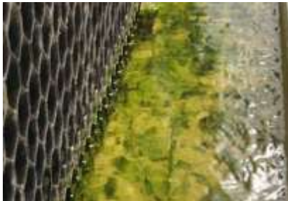
Figure 10- Exemple d'un encrassement biologique
